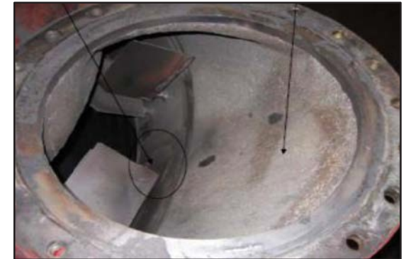
La tubería de salida después de 40K horas, muestran pequeñas manchas que requieren reparación con ARC .
